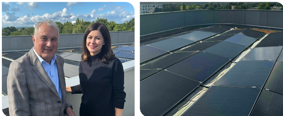
Panneaux photovoltaïques, toit du siège du Groupe Interaction, Rennes
